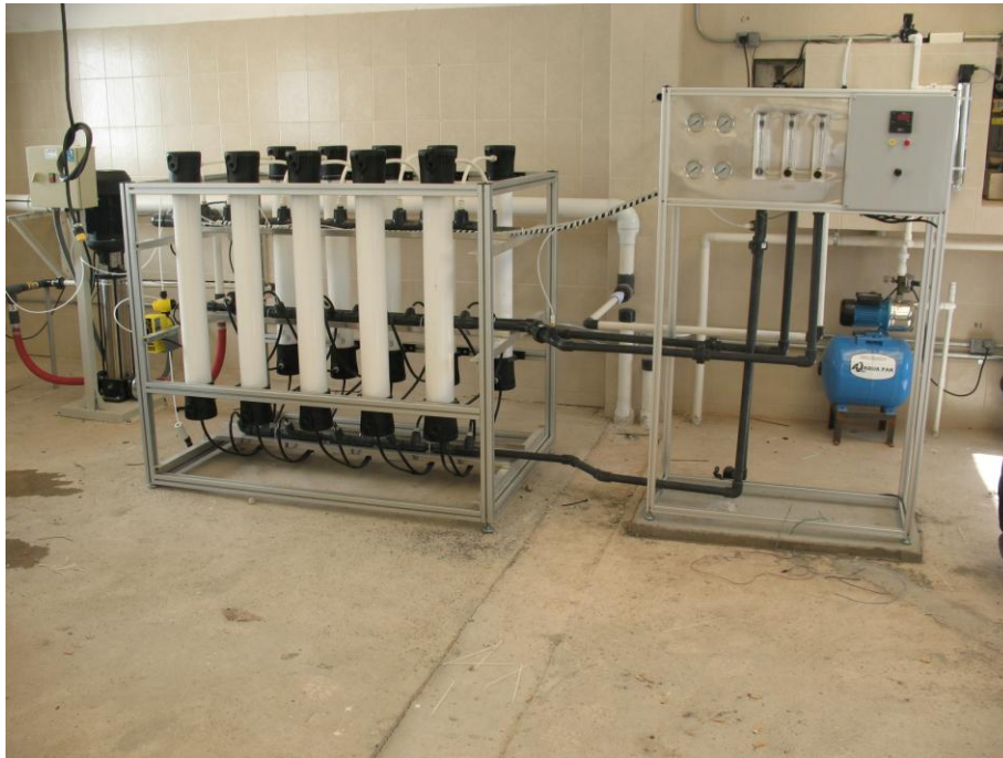
Equipo de osmosis inversa con capacidad de 80,000 litros por día, para la producción de agua desmineralizada.
