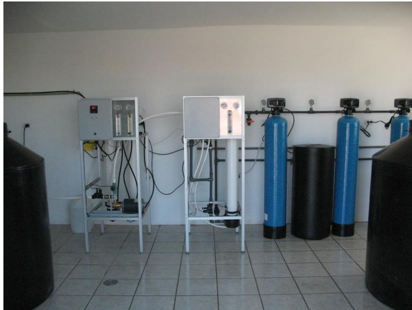
Planta potabilizadora con capacidad de 15,000 litros por día para remoción de flúor, arsénico y otros contaminantes en la fuente de agua.
